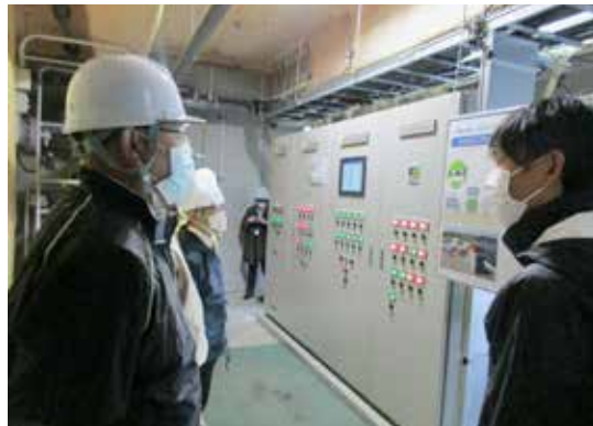
バイオガスプラント
